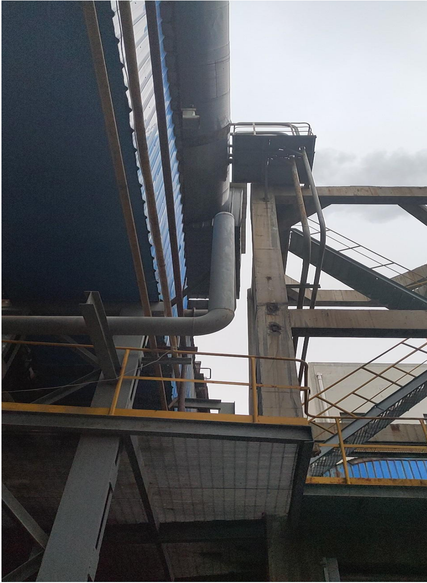
废气处理系统
