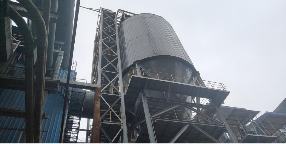
附件 7：现场设备及防护措施照片
