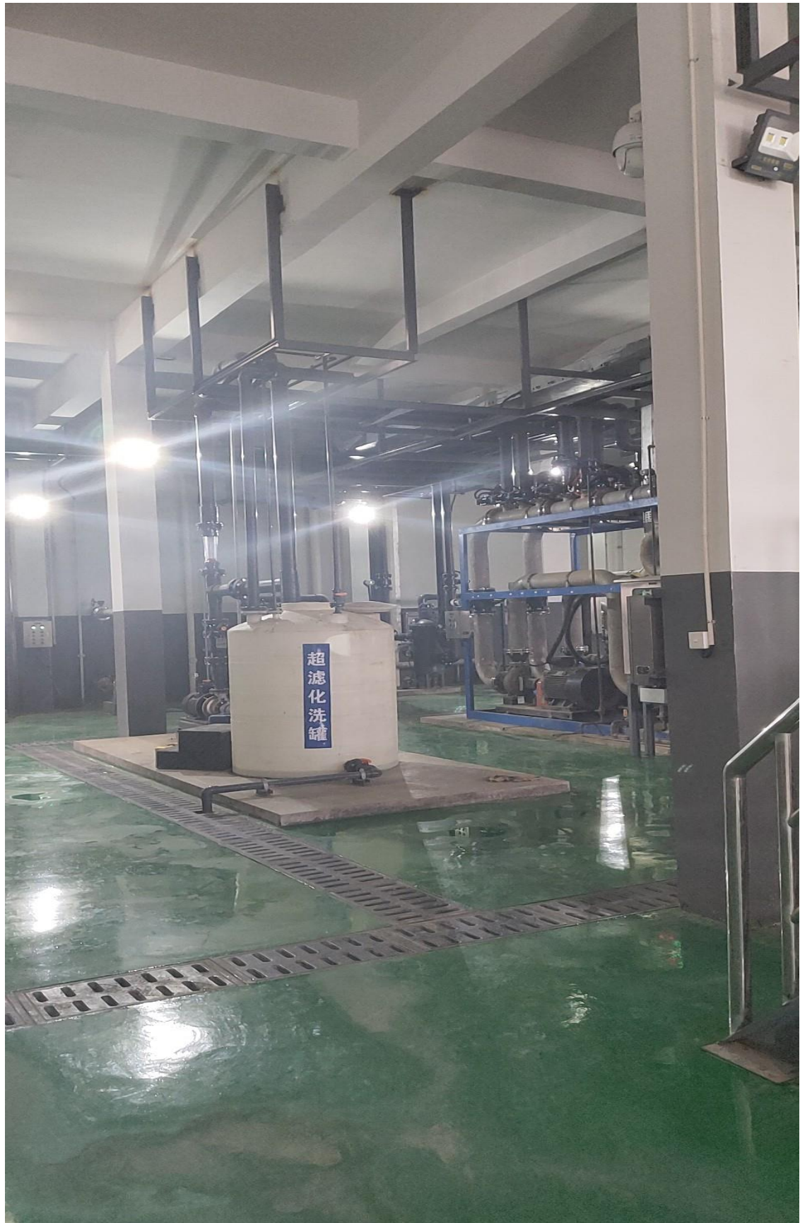
废水处理设施
